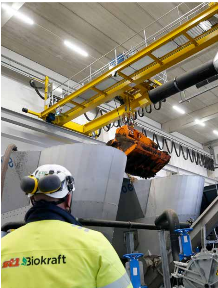
Med hjälp av kranarna lyfter man den inkommande gödseln från lastbilen och tömmer i biomixern.
